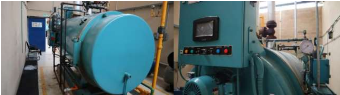
Figura 3. Fotografías de la caldera en el laboratorio de Ingeniería Química.
